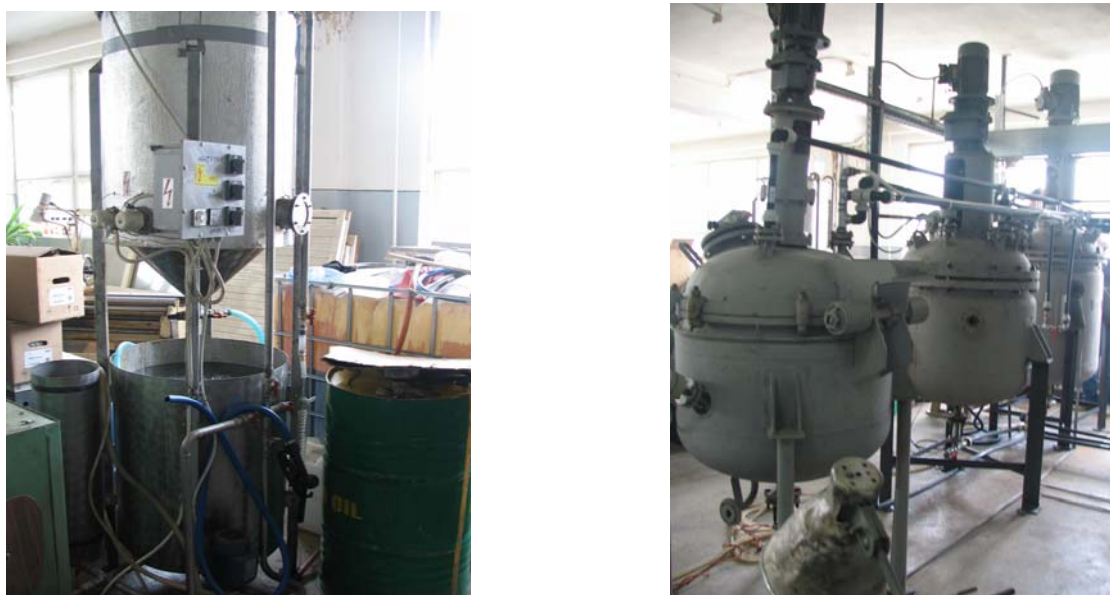
Fig. 19. Instalație de transesterificare a uleiului vegetal (I.C.I.A. Cluj-Napoca)
